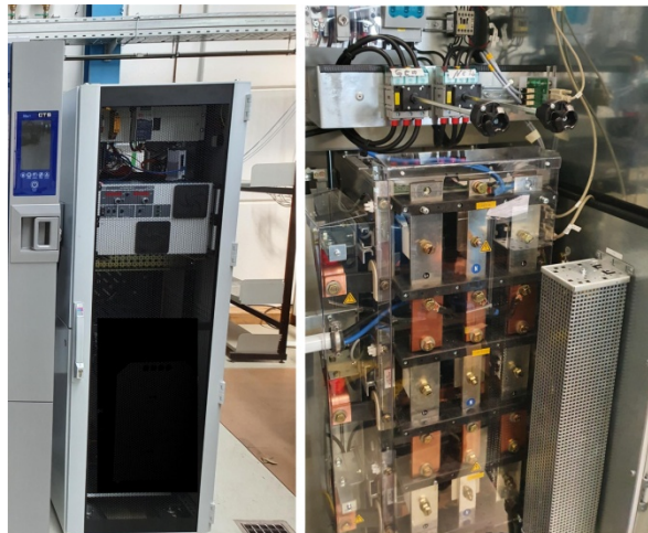
Abbildung 16: Mittelspannungsanlage (Bild rechts), Hilfsumrichter (Bild links)
