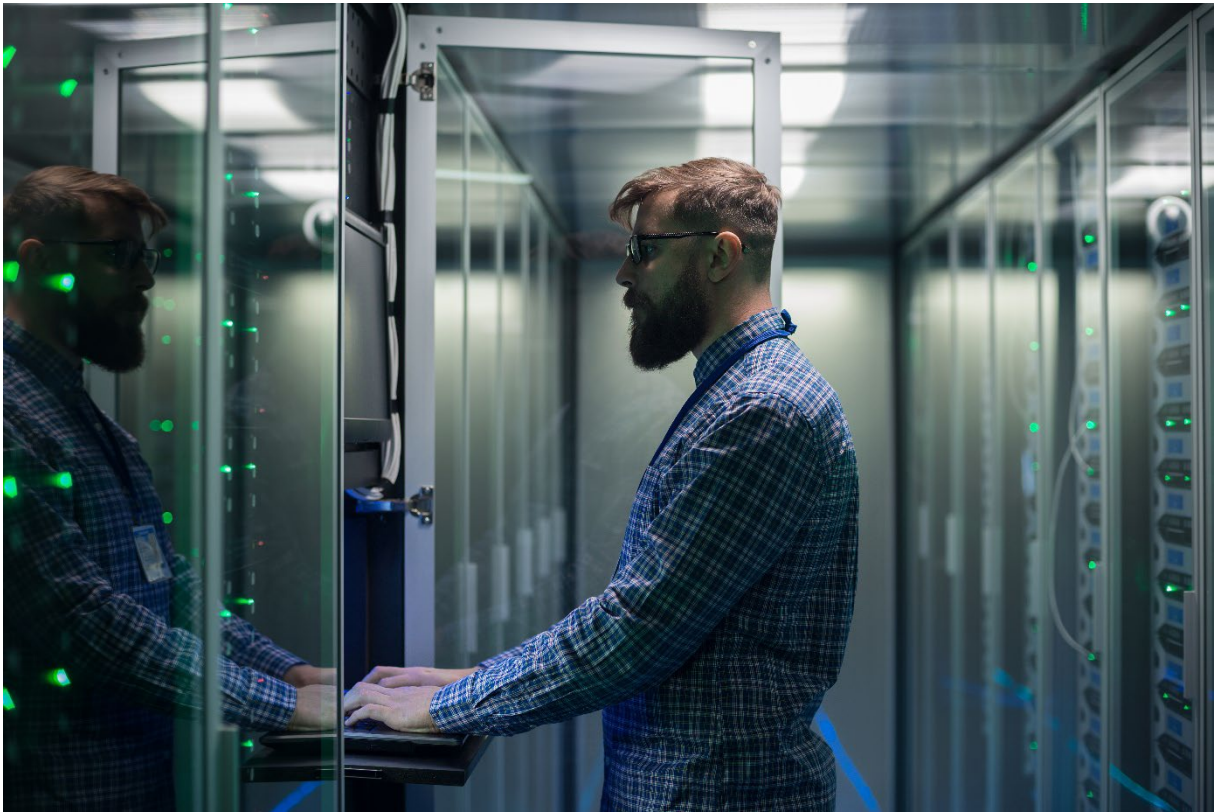
Bild: Mitarbeiter im Serverraum. Bildquelle: © Framestock.stock.adobe
